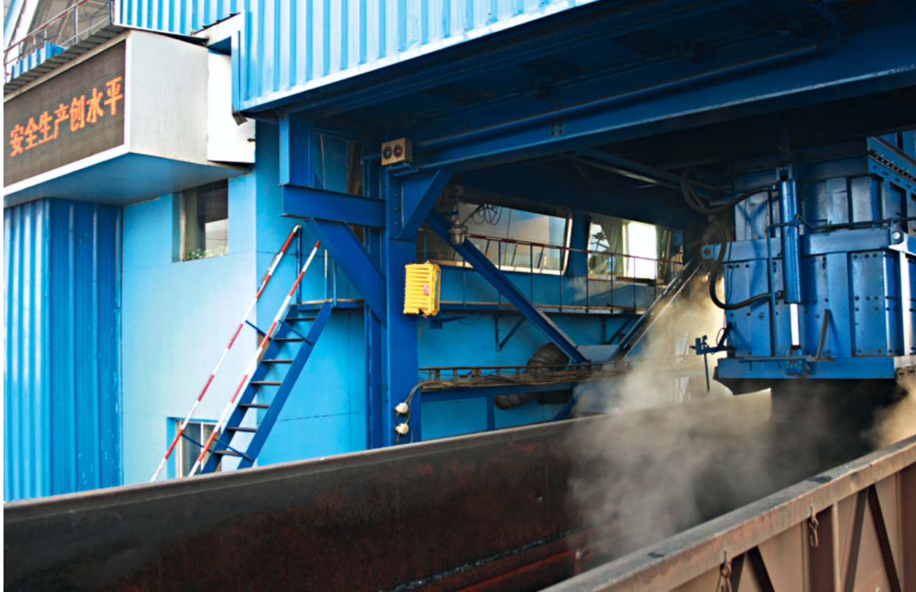
自動化封閉煤炭裝車系統
