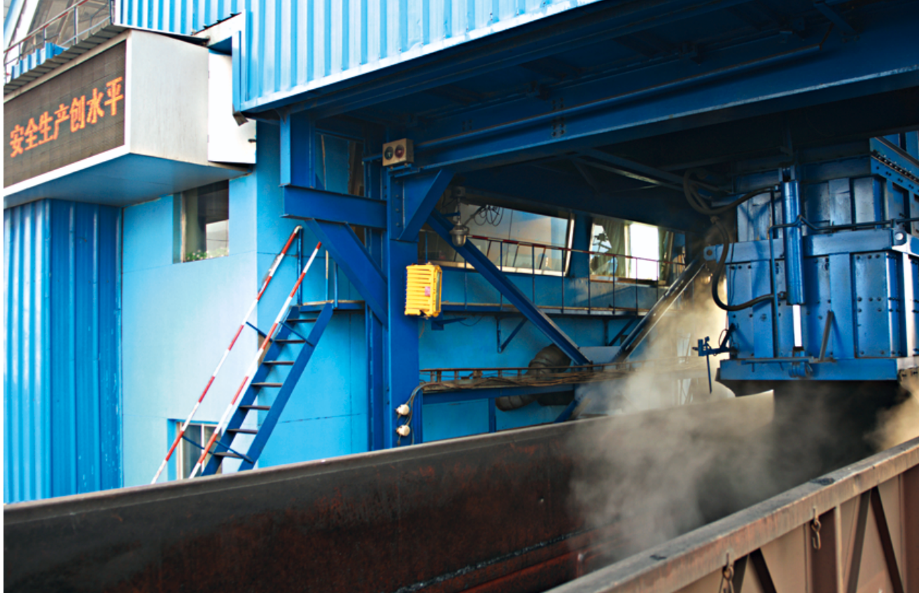
自动化封闭煤炭装车系统
